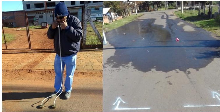
Figura 3 - Utilização do geofone na identificação de fissuras e demarcação do local.
